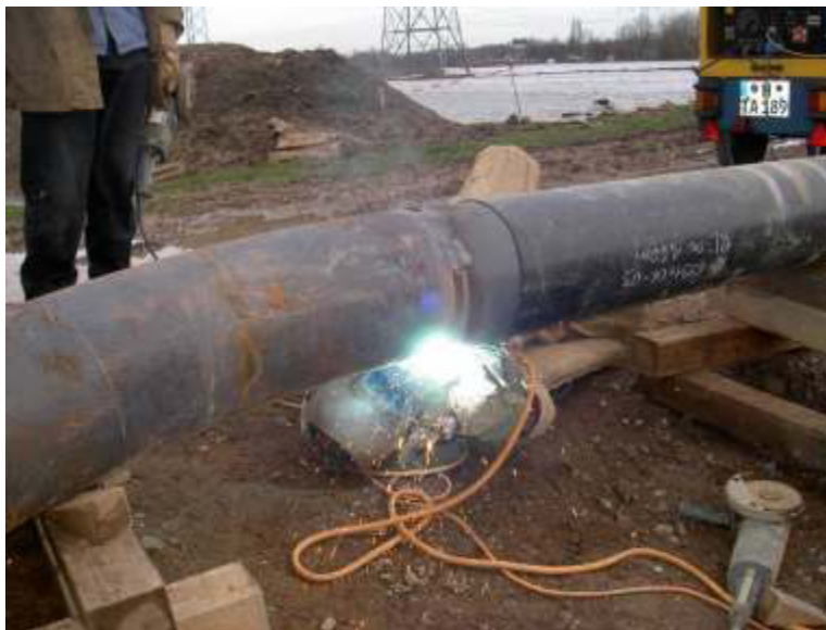
Schweißen wie im Wilden Westen - das Regelwerk dient allenfalls als Unterlegkeil. (Foto: Dieter Donner)
