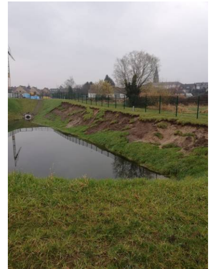
Das Versickerungsbecken entwässert die Umgebung
